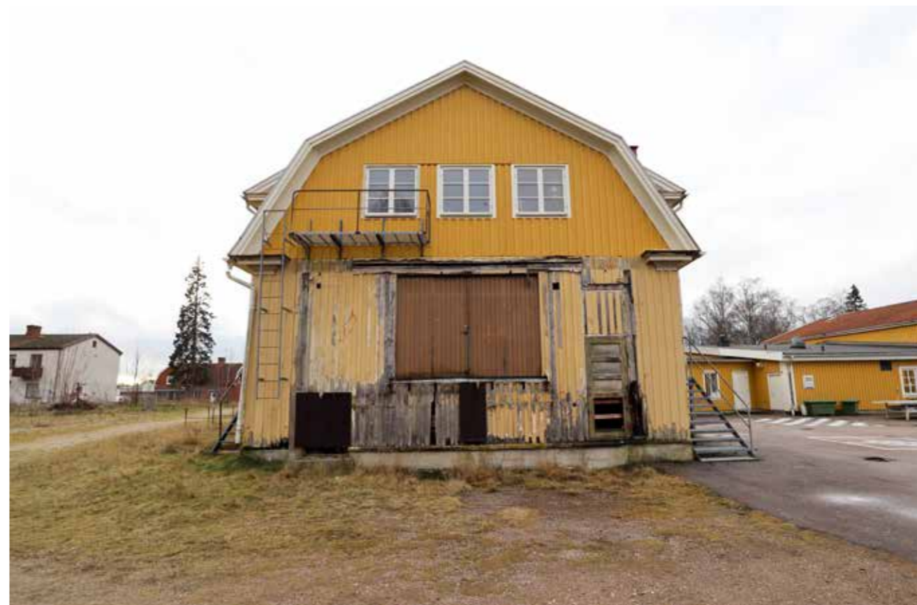
Bakom scenbyggnaden finns en fallfärdig lastbrygga med portar in till rekvisitaförrådet..
