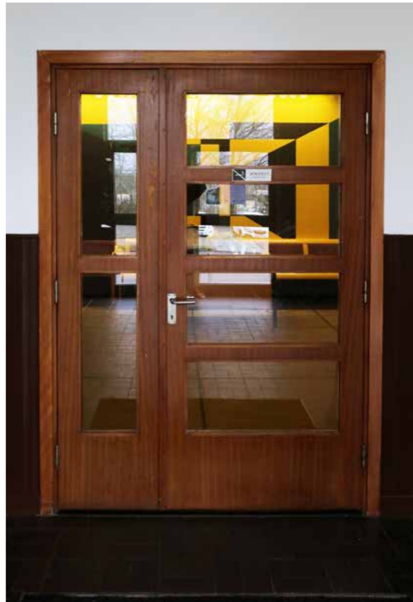
Dörren mellan Entréhallen och foajén. Dörrens faner har skador.
